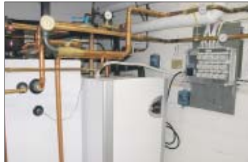
Maalämmityksen ”pannuhuoneen” varustelun tilantarve on todella pieni. Pienimmissä yksiköissä kompressori, lämpöpumppu ja vesivaraaja ovat samassa kaapissa. Tässä tehokkaammissa yksiköissä lämminvesivaraaja on erikseen vasemmalla. Automaattika hoitaa tehosäätelyt isäntävään haluamalla tavalla.
