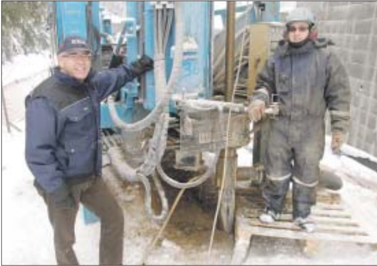
Tällä kertaa ollaan uudisrakennustyömaalla Espoon Laaksolahdessa. 12 kW tehoa varten tehdään 195 metriä reikää ja kokonaiskustannus asiakkaalle on noin 18 500 e. Viereiseen isompaan omakotitaloon tulee 16 kW lämpöpumppu, jota varten tehdään kaksi 155 m reikää. Tämä projekti on kokonaisarvoltaan noin 22 000 e. Kuvassa Tom Allen (vas.) ja Jonas Johansson Porvoosta.
